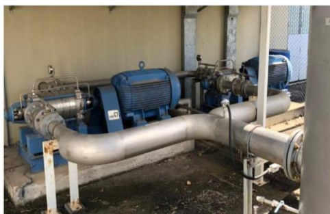
Figura 2 – Bombas de água de 175 e 250 HP-cv
